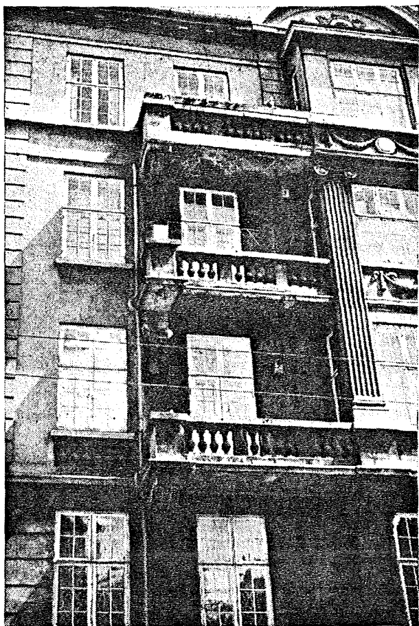
Fig. 3. Billedet viser bygningens altaner. Konsollen under tredje etages altan mangler.
